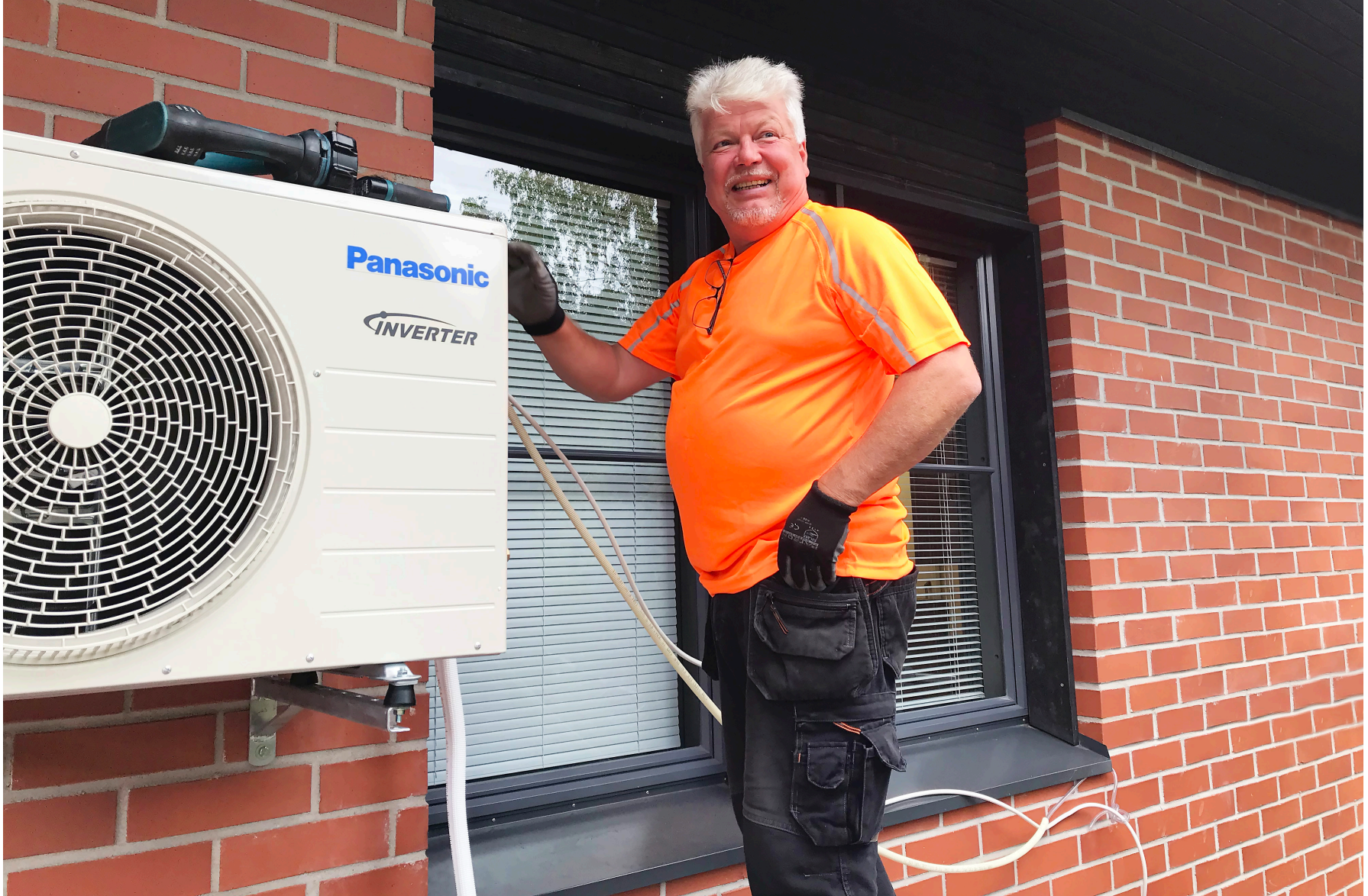
Ismo Tuominen varmistaa, että Naantalin kaupungin kiinteistöissä tehdään töitä raikkaassa ja viileässä ilmassa. Rymättylän koulun keittiön ilmalämpöpumppu vaihdettiin uuteen ennen koulujen alkua.
