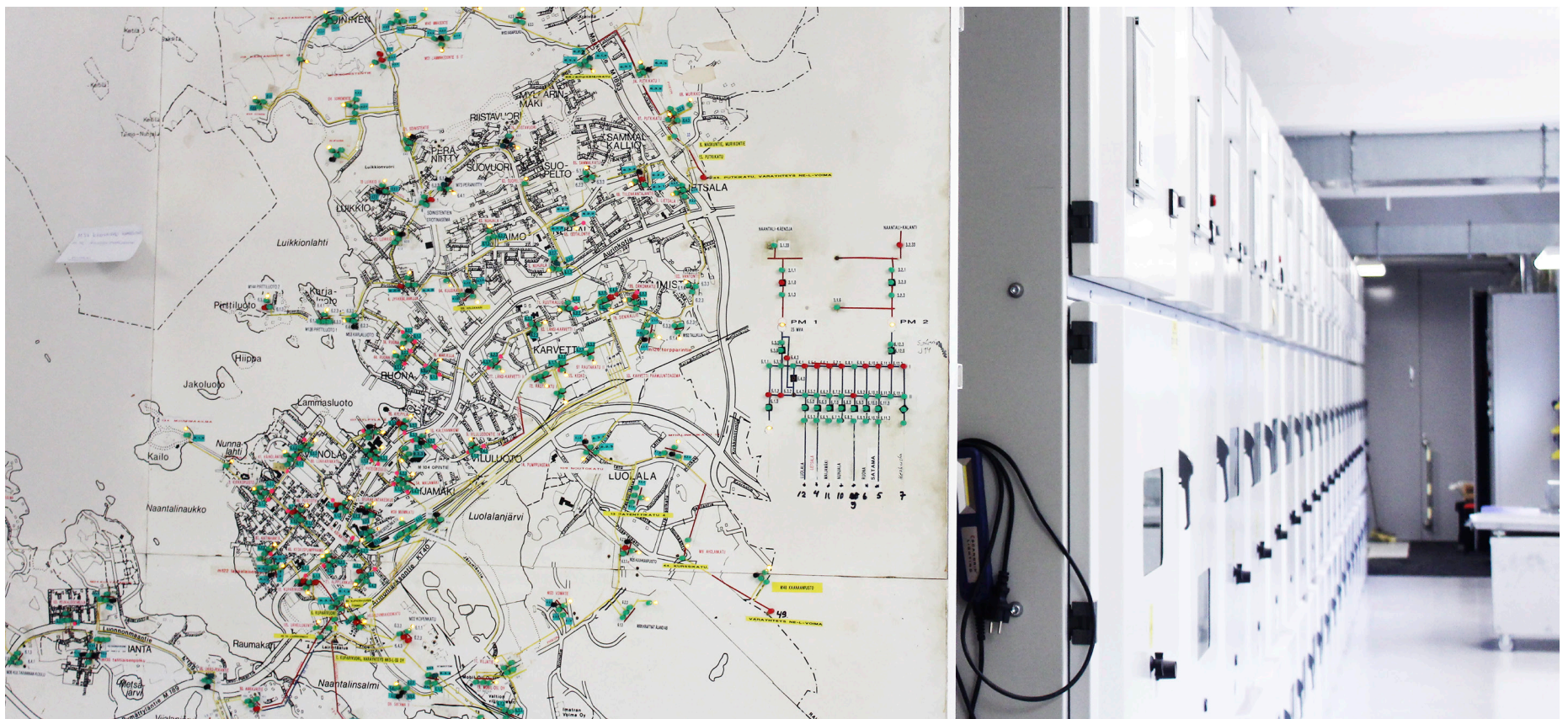
Karvetin sähköasemalla havaitaan mahdolliset häiriöt ja huolehditaan sujuvasta sähköjakelusta Kanta-Naantalin alueella.
